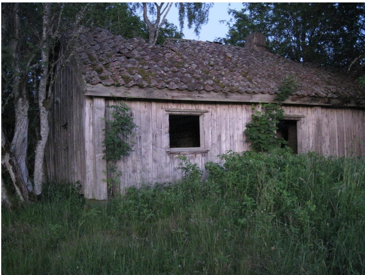
Bild 60: Fornstugan. Den står uppe på berget ovanför bygdegården men är i väldigt dåligt skick (2023).
